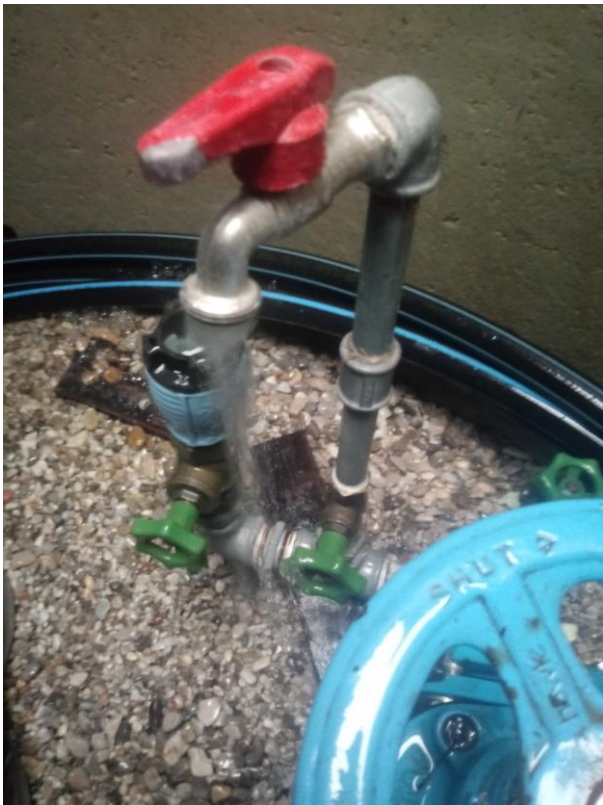
Abbildung 38: WVA Gemeindewasserversorgungsverband Felixdorf – Sollenau, Ortsnetz Sollenau, Bereich Schneebergstr. / Funpark, Blick zur Probenahmestelle im Übergabeschacht.
