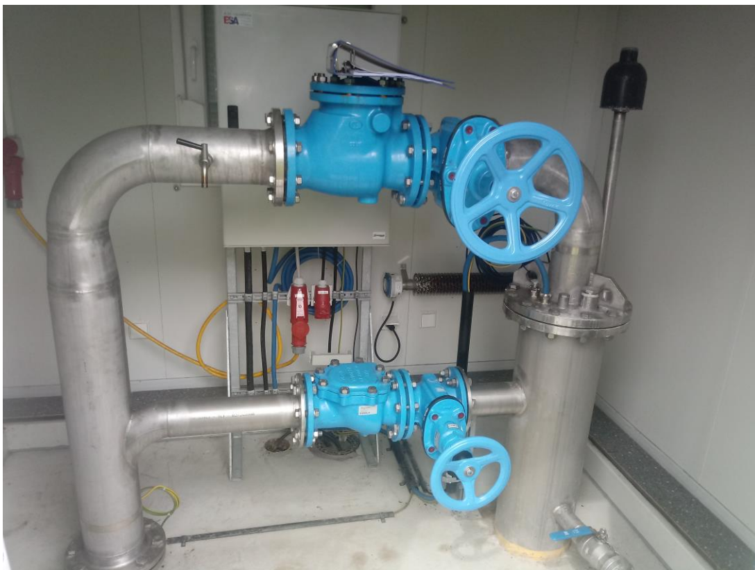
Abbildung 11: WVA Gemeindevwasserversorgungsverband Felixdorf – Sollenau, Bohrbrunnen 11, Blick zum Brunnen.
