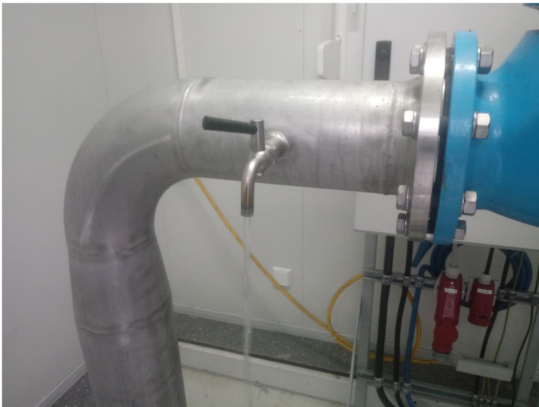
Abbildung 12: WVA Gemeindevwasserversorgungsverband Felixdorf – Sollenau, Bohrbrunnen 11, Blick zur Probenahmestelle.
