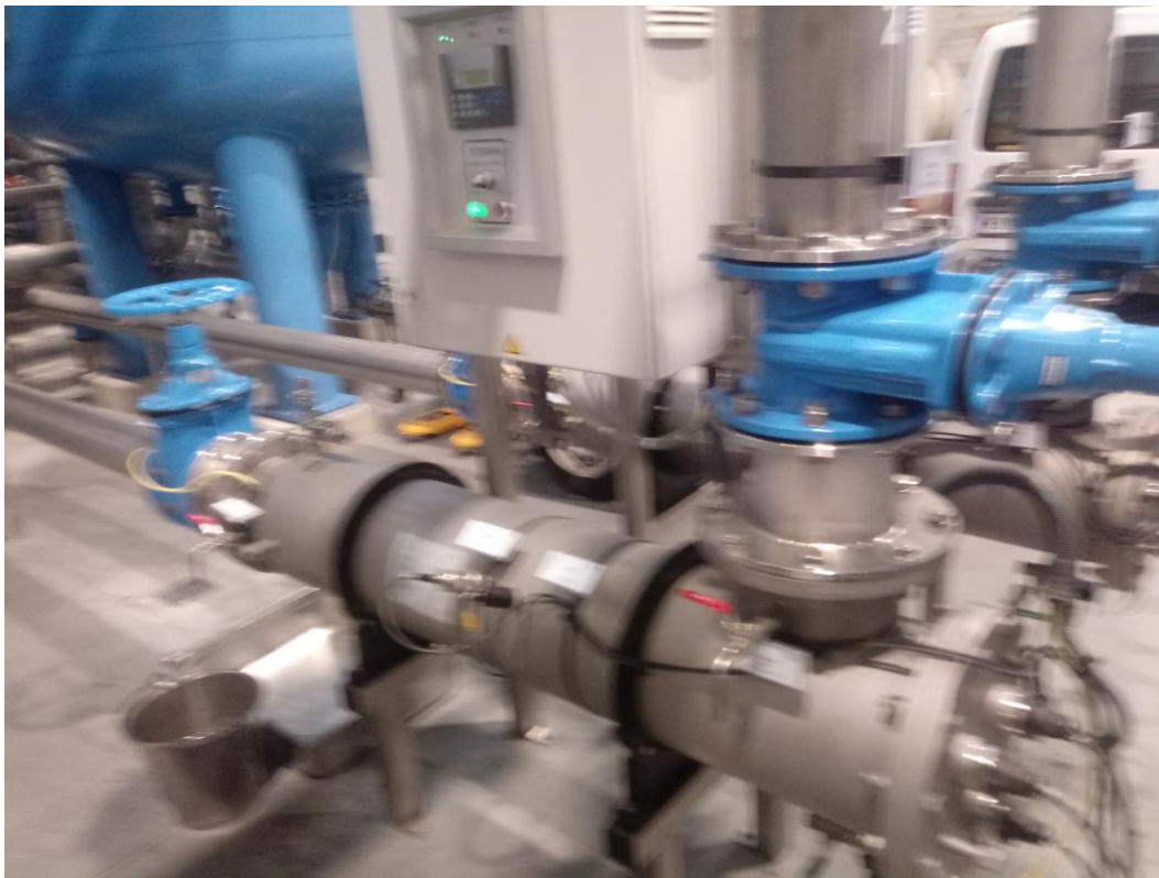
Abbildung 19: WVA Gemeindewasserversorgungsverband Felixdorf – Sollenau, Aufbereitungsstraße 1, Gerät zur Desinfektion von Wasser mittels Ultraviolettstrahlung 2, nach Mehrschichtfilter Linie 2.
