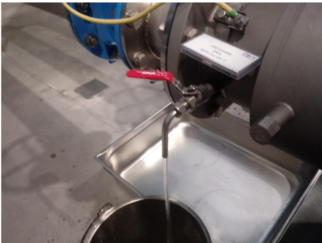
Abbildung 20: WVA Gemeindewasserversorgungsverband Felixdorf – Sollenau, Aufbereitungsstraße 1, Gerät zur Desinfektion von Wasser mittels Ultraviolettstrahlung 2, nach Mehrschichtfilter Linie 2, Probenahme vor Desinfektion.
