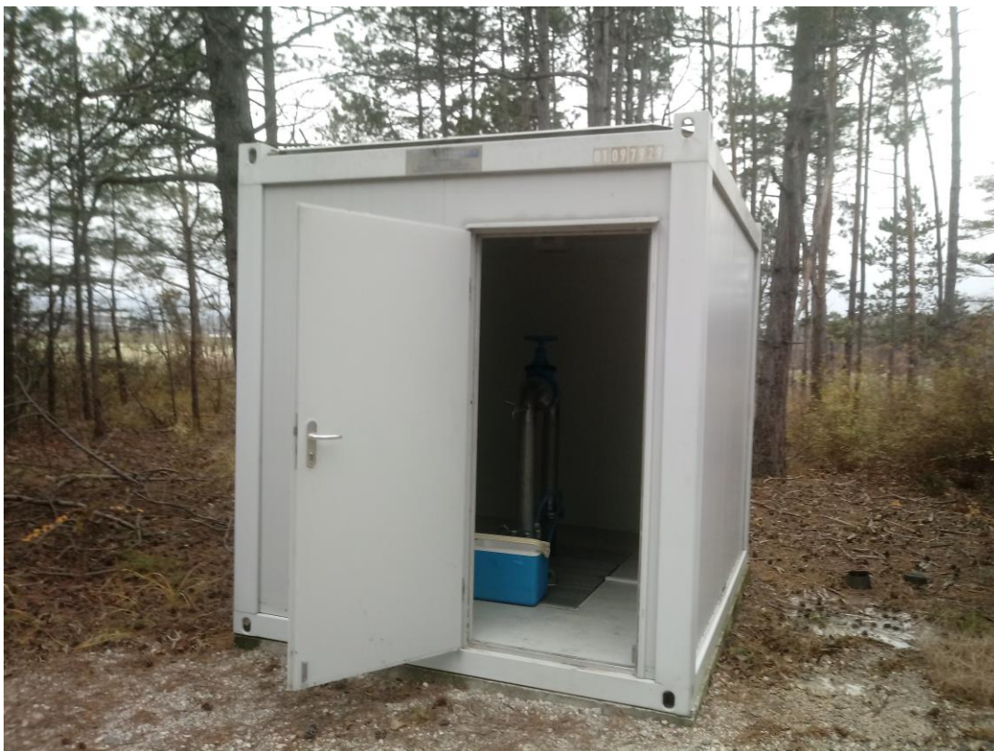
Abbildung 1: WVA Gemeindewasserversorgungsverband Felixdorf – Sollenau, Bohrbrunnen 4a, Blick zum Brunnenhaus.
