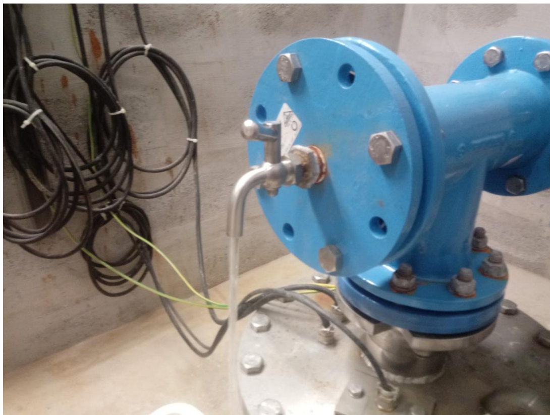
Abbildung 9: WVA Gemeindewasserversorgungsverband Felixdorf – Sollenau, Bohrbrunnen 2, Blick zur Probenahmestelle.
