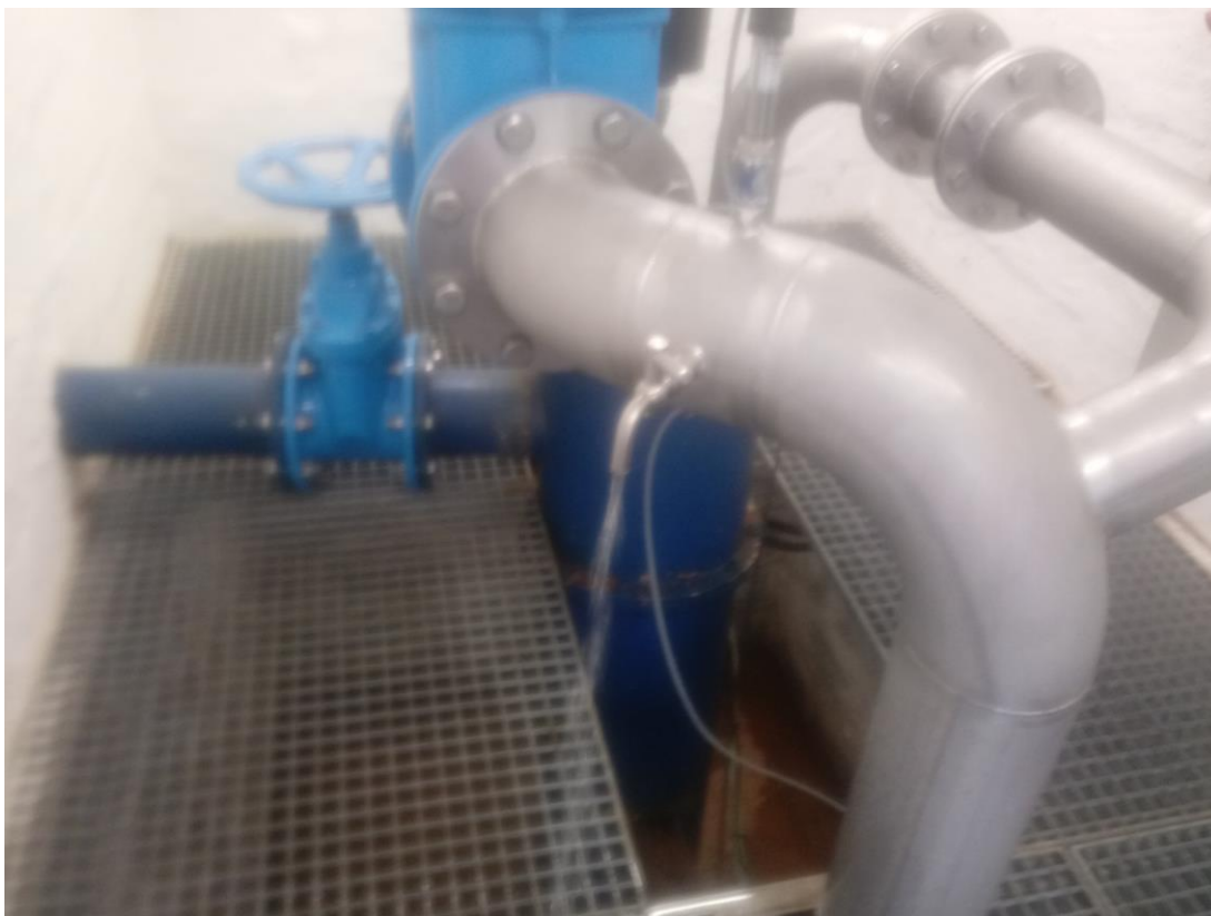
Abbildung 15: WVA Gemeindevasserversorgungsverband Felixdorf – Sollenau, Bohrbrunnen 7, Blick zur Probenahmestelle.
