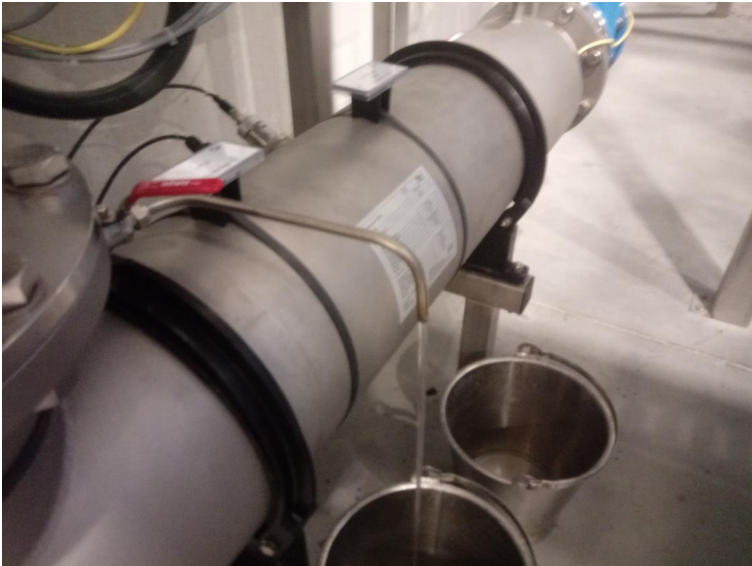
Abbildung 23: WVA Gemeindewasserversorgungsverband Felixdorf – Sollenau, Aufbereitungsstraße 3 (Wasser des Bohrbrunnen 2), Blick zum Gerät zur Desinfektion von Wasser mittels Ultraviolettstrahlung 5, Probenahmehahn nach Desinfektion.
