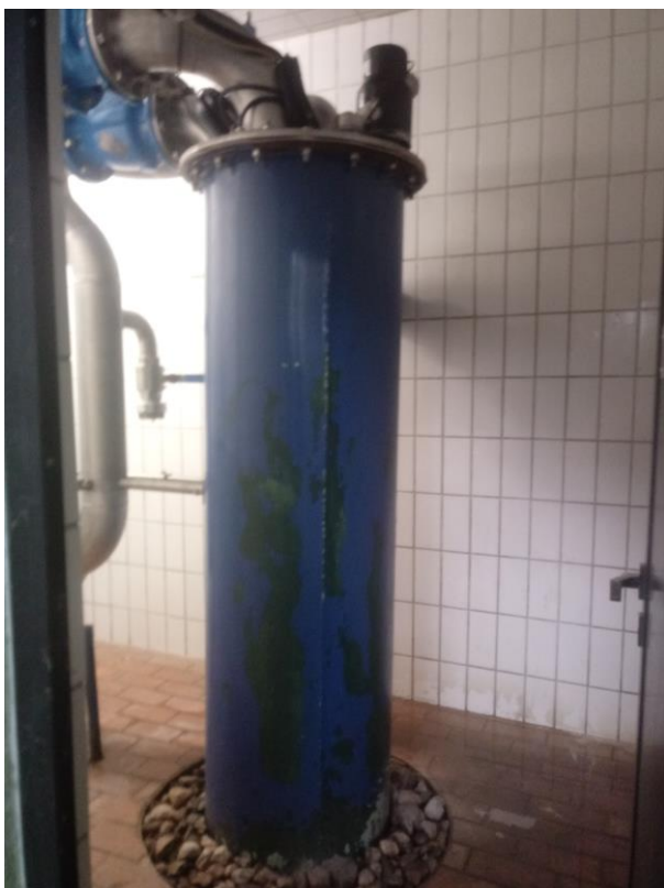
Abbildung 32: WVA Gemeindewasserversorgungsverband Felixdorf – Sollenau, Blick zum Bohrbrunnen 8a Sollenau.
