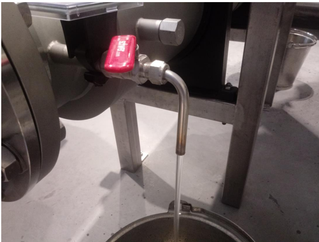
Abbildung 17: WVA Gemeindewasserversorgungsverband Felixdorf – Sollenau, Aufbereitungsstraße 1, Gerät zur Desinfektion von Wasser mittels Ultraviolettstrahlung 1, nach Mehrschichtfilter Linie 1, Probenahme nach Desinfektion.
