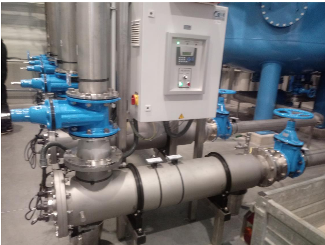
Abbildung 16: WVA Gemeindevasserversorgungsverband Felixdorf – Sollenau, Aufbereitungsstraße 1, Gerät zur Desinfektion von Wasser mittels Ultraviolettstrahlung 1, nach Mehrschichtfilter Linie 1.
