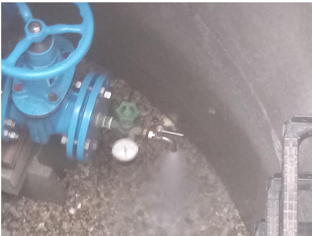
Abbildung 40: WVA Gemeindewasserversorgungsverband Felixdorf – Sollenau, Probenahmeahn im Übergabeschacht WVA Maria Theresiensiedlung.
