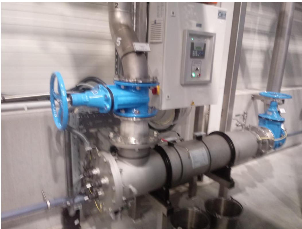
Abbildung 22: WVA Gemeindewasserversorgungsverband Felixdorf – Sollenau, Aufbereitungsstraße 3 (Wasser des Bohrbrunnen 2), Blick zum Gerät zur Desinfektion von Wasser mittels Ultraviolettstrahlung 5.
