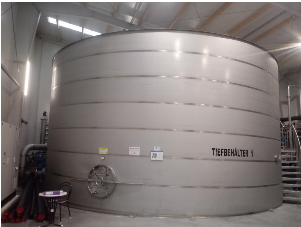
Abbildung 24: WVA Gemeindewasserversorgungsverband Felixdorf – Sollenau, Blick zum Tiefbehälter 1 Felixdorf (neu).
