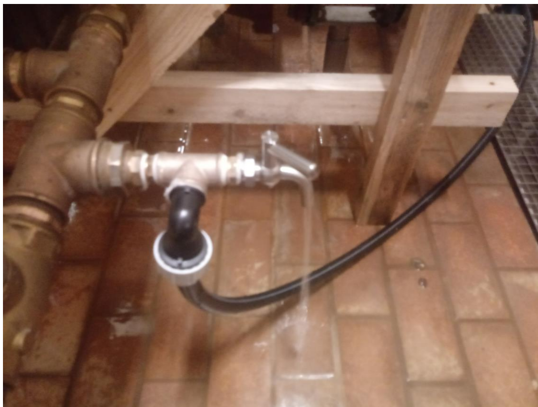
Abbildung 30: WVA Gemeindewasserversorgungsverband Felixdorf – Sollenau, Tiefbehälter 3 Sollenau, Probenahmeahn Ablauf.
