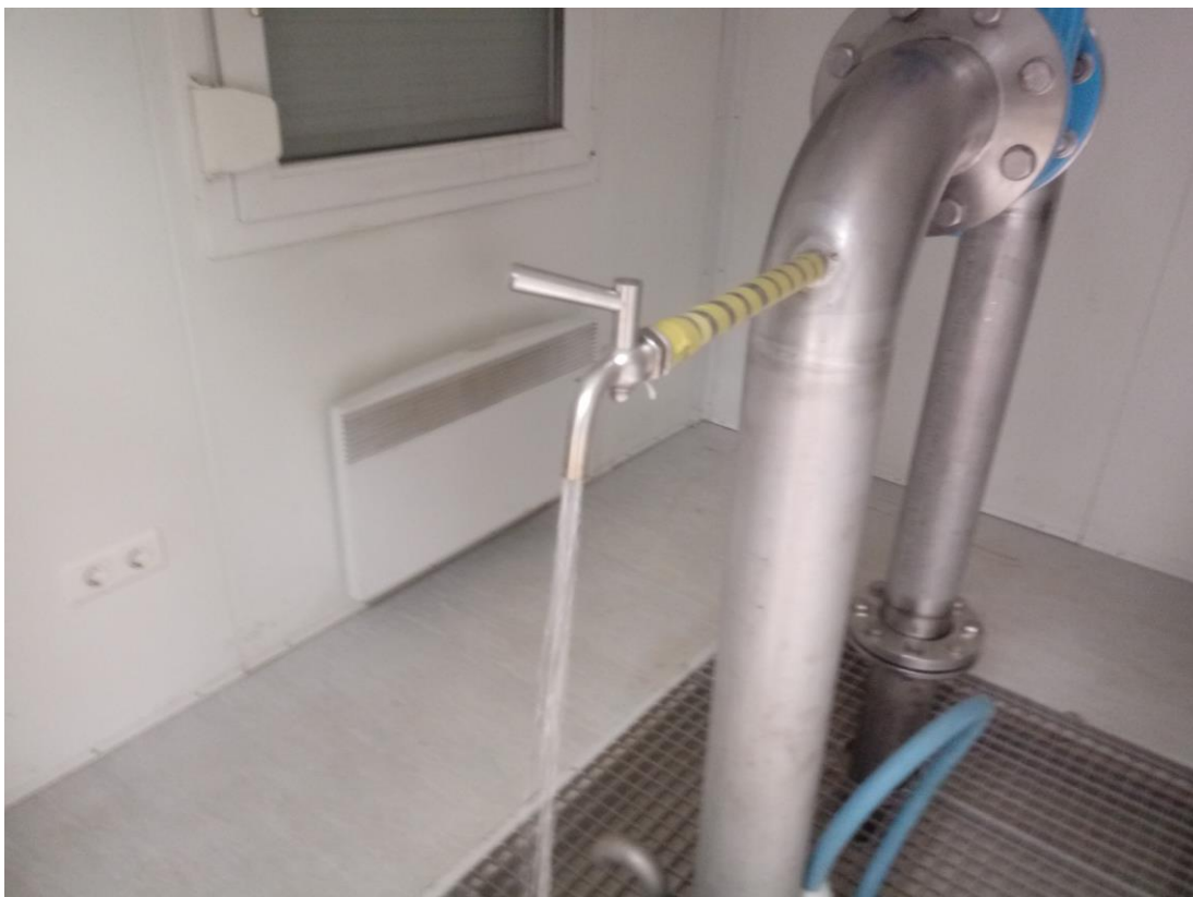
Abbildung 3: WVA Gemeindewasserversorgungsverband Felixdorf – Sollenau, Bohrbrunnen 4a, Blick zur Probenahmestelle.
