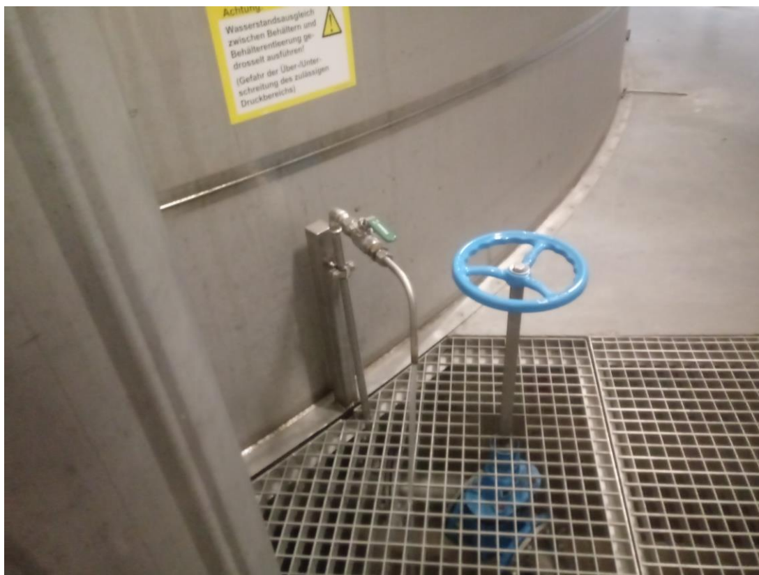
Abbildung 25: WVA Gemeindevasserversorgungsverband Felixdorf – Sollenau, Tiefbehälter 1 Felixdorf (neu), Probenahmeahn Ablauf.
