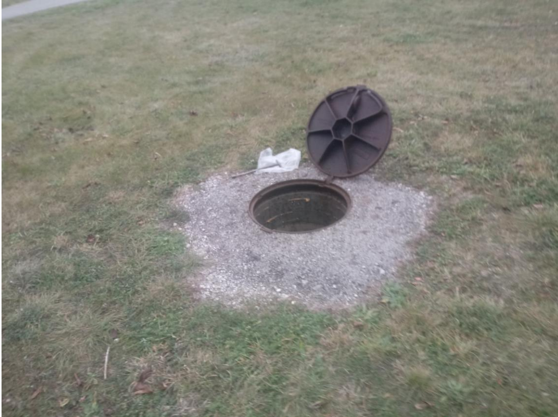
Abbildung 37: WVA Gemeindewasserversorgungsverband Felixdorf – Sollenau, Ortsnetz Sollenau, Bereich Schneebergstr. / Funpark, Blick zum Übergabeschacht.
