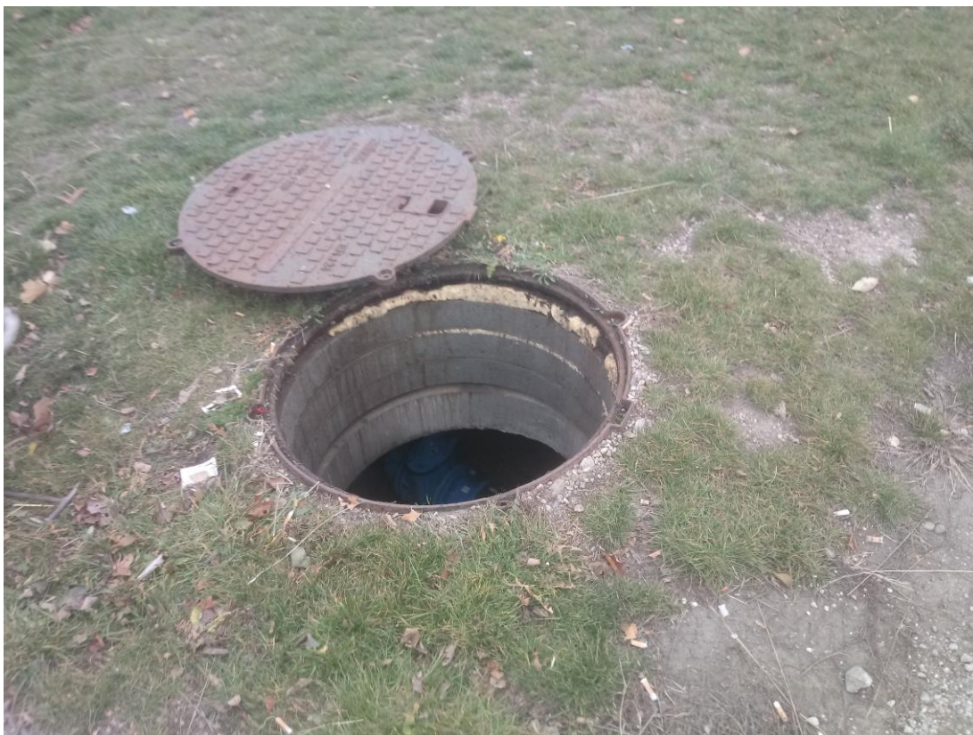
Abbildung 39: WVA Gemeindewasserversorgungsverband Felixdorf – Sollenau, Übergabeschacht WVA Maria Theresiensiedlung.
