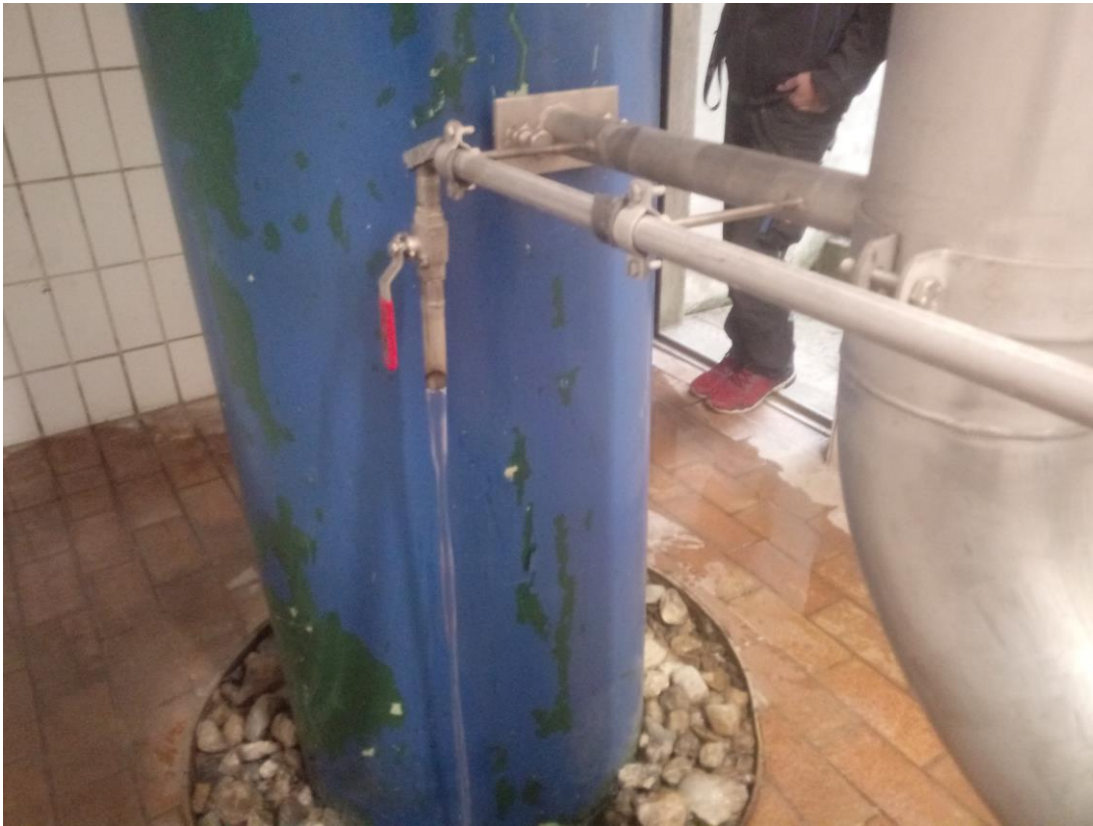
Abbildung 33: WVA Gemeindewasserversorgungsverband Felixdorf – Sollenau, Blick zum Bohrbrunnen 8a Sollenau, Probenahmeahn.
